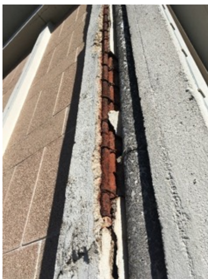
Béton carbonaté sur bâtiment
