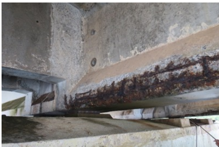
Corrosion sur un talon de poutre avec perte de section en milieu maritime
